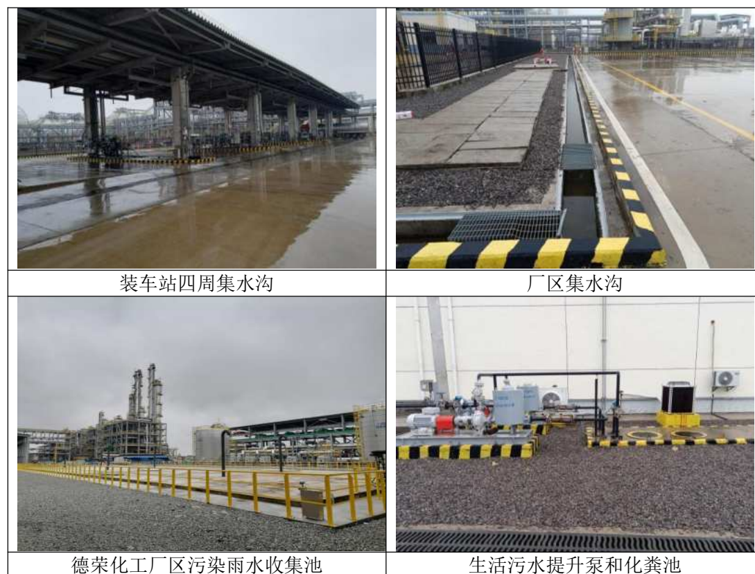
图 3-3 废水收集设施照片
