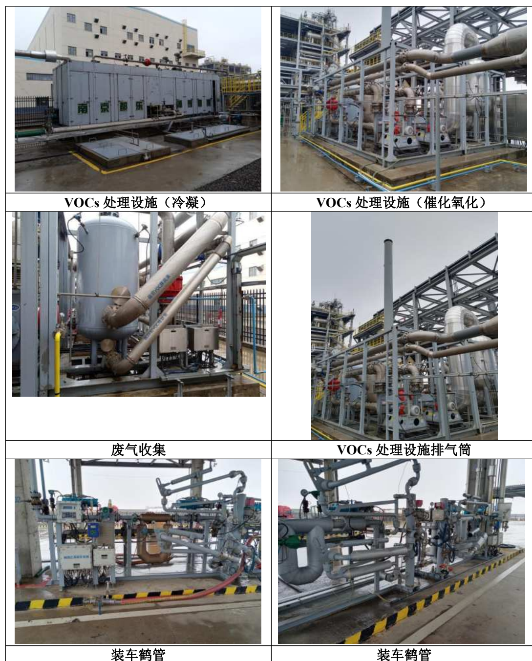
图 3-1 废气治理措施照片
